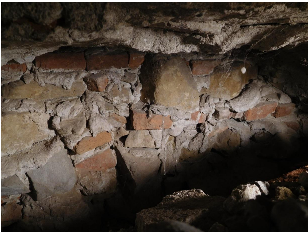
Vnútro vyhrievacej komory
